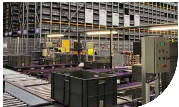
Transstockeur - Plateforme de Lavour (81)
